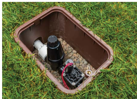
PCZ-101 instalado en una arqueta polivalente
